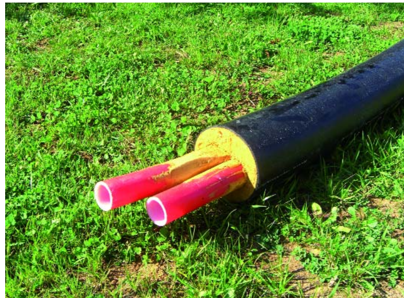
Abbildung 1: Von der Dorfmitte aus verlaufen die Wärmeleitungen von Haus zu Haus. (Fotos: Markt Lauterhofen)
