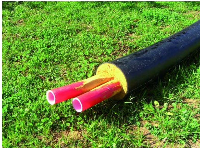
Abbildung 1: Von der Dorfmitte aus verlaufen die Wärmeleitungen von Haus zu Haus. (Fotos: Markt Lauterhofen)
