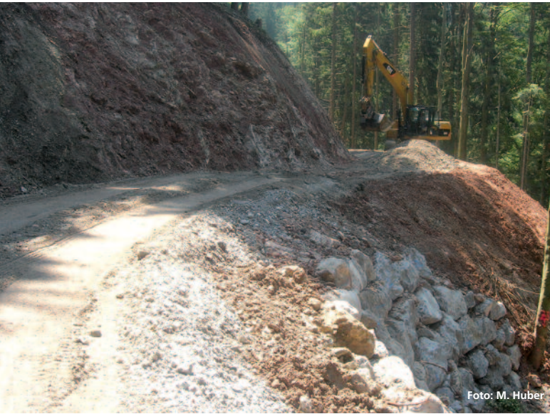
Abbildung 1: Der Bau LKW-befahrbarer Waldwege war ein wichtiger Schritt in die moderne Bergwaldwirtschaft.
