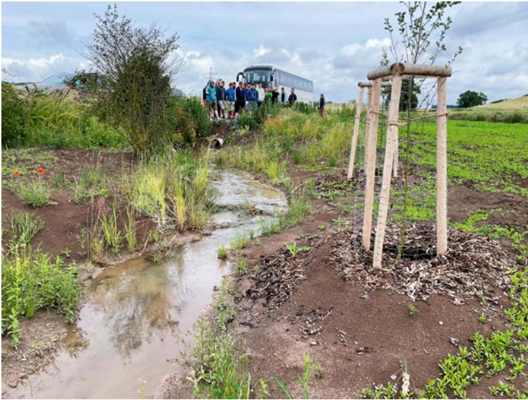
▭ Bild 4: Naturnaher Wasserbau und Ingenieurbiologie als Spezialisierungen des Landschaftsbaus – Wichtig ist eine gute Bauzeitenplanung, um optimale Ergebnisse zu erzielen. Anders als im urbanen Landschaftsbau müssen die neu angelegten Ansaaten und Pflanzungen später ohne Bewässerung auskommen (Foto: FNO Sulzdorf)
