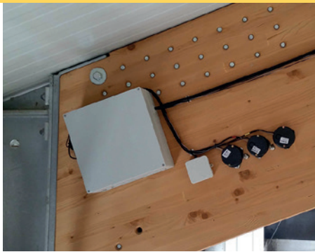
2 Messstelle zur Feuchteermittlung im Holz in einem Geflügelstall. Foto: TUM
